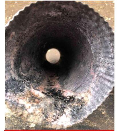
煙突内のタール
