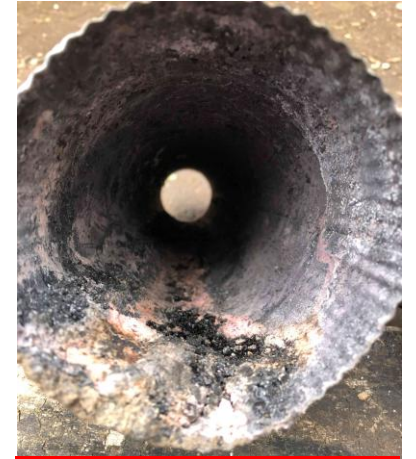
煙突内のタール
